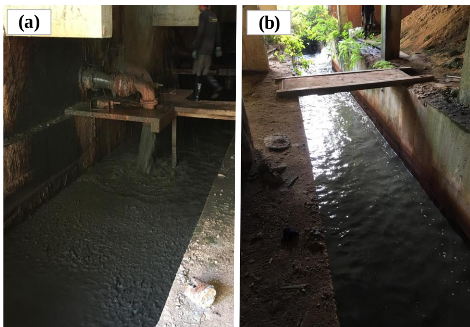
Figura 2.3 – Descarte do resíduo da ETA Bolonha: (a) válvula de descarga do decantador e (b) canal de descarga do lodo.
